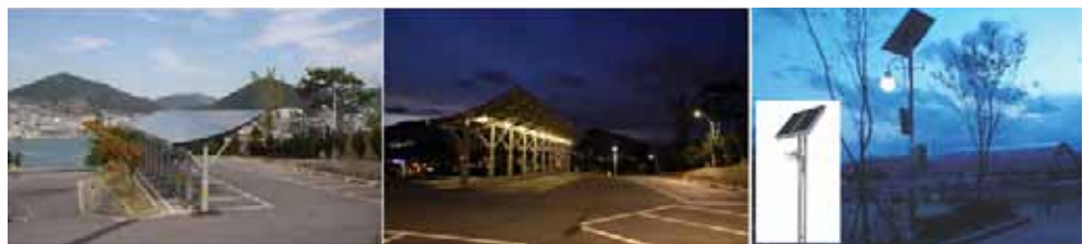
▲권장 : 태양광발전설비를 지닌 경관조명기구 설치사례
